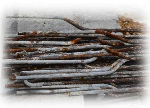
Εικ.12. Διαβρωμένος σπλισμός από οικοδομικά μπάζα στα βόρεια κτήρια.
