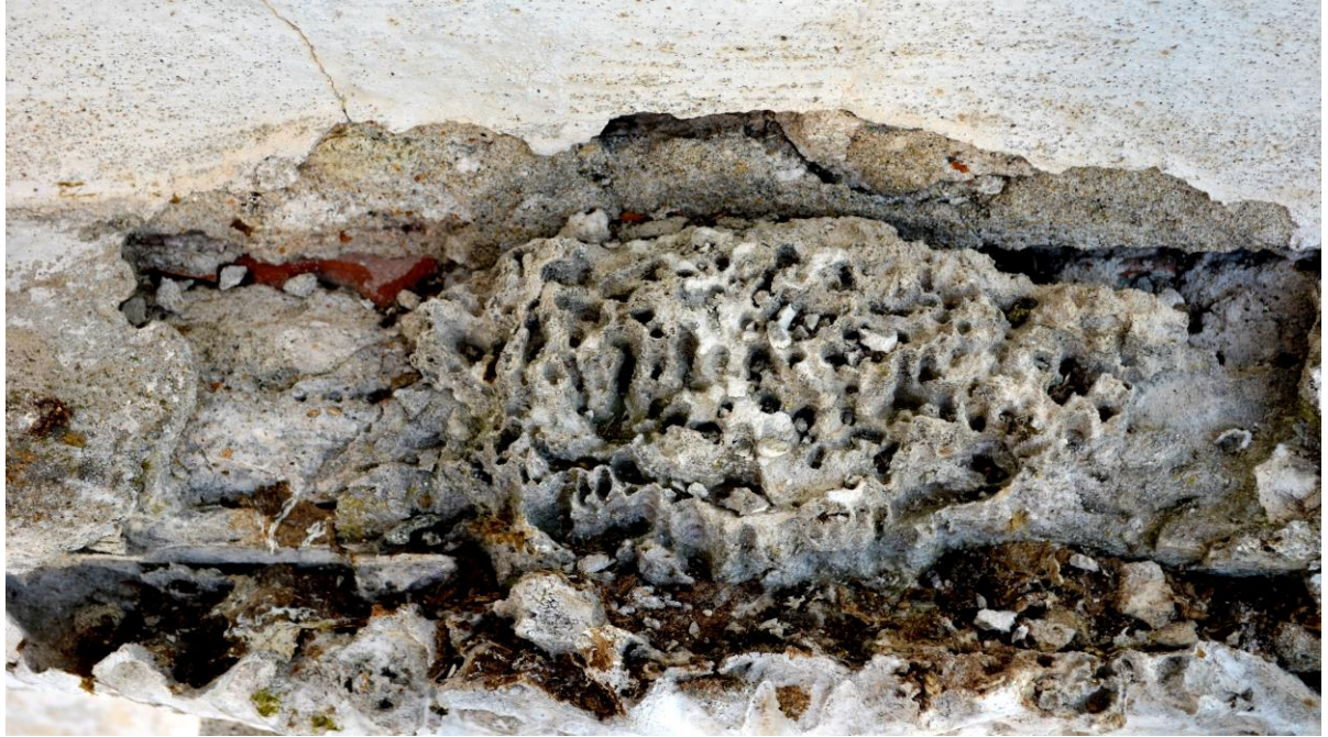
Εικ.59 Χαλαρές επικαθίσεις-Βιολογικές αναπτύξεις – Σαθροποίηση- Απώλεια τμήματος Κρυφελοποίηση – Φωλιές εντόμων σε γύψινο διακοσμητικό
