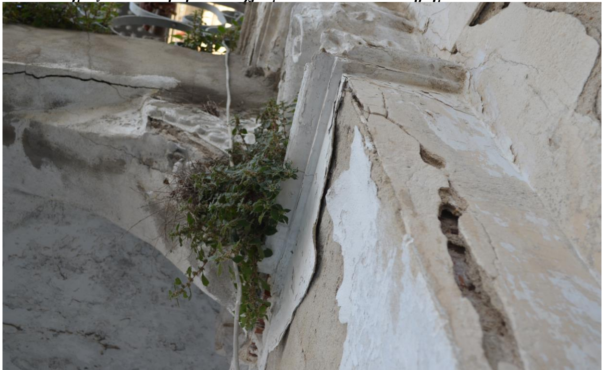
Εικ.44 Ρωγμές-Αποκόλληση των επιχρισμάτων από το υποστήριγμα-Απώλειες-Ανάπτυξη φυτών
