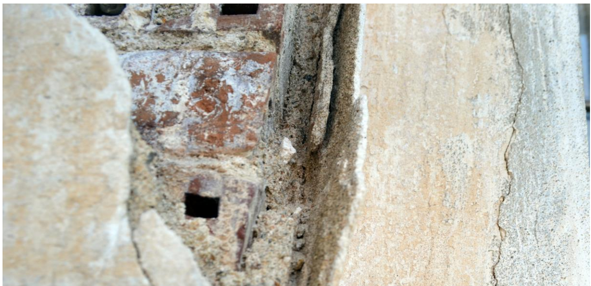
Εικ.46 Ολική απώλεια κονιάματος
