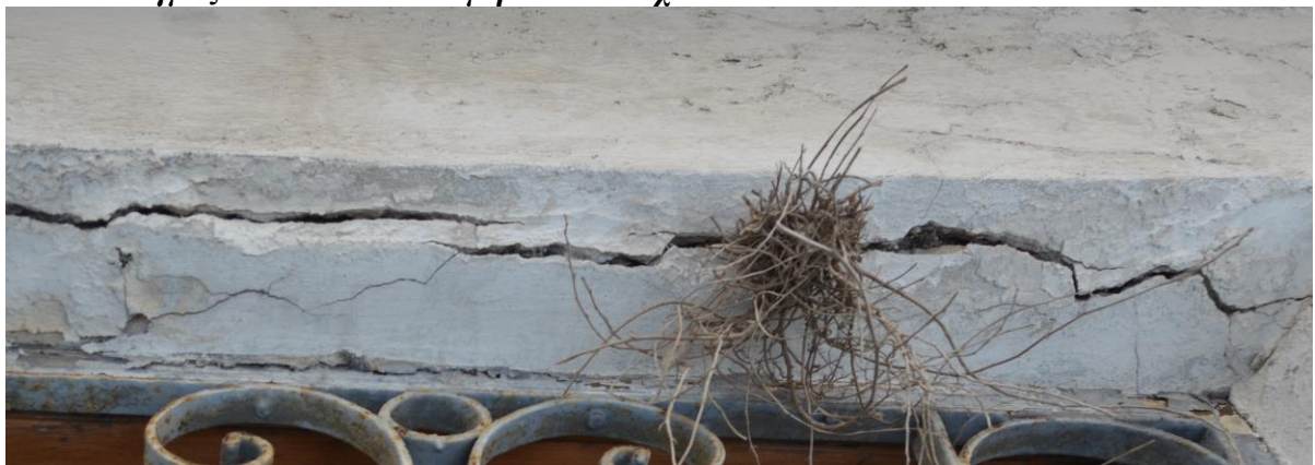
Εικ.43 Ρωγμές-Αποκόλληση των επιχρισμάτων από το υποστήριγμα
