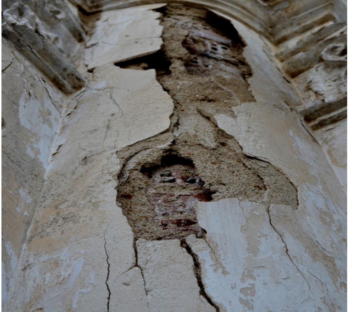
Εικ.45 Ρωγμές - Αποκόλληση και απώλεια τμημάτων των επιχρισμάτων
