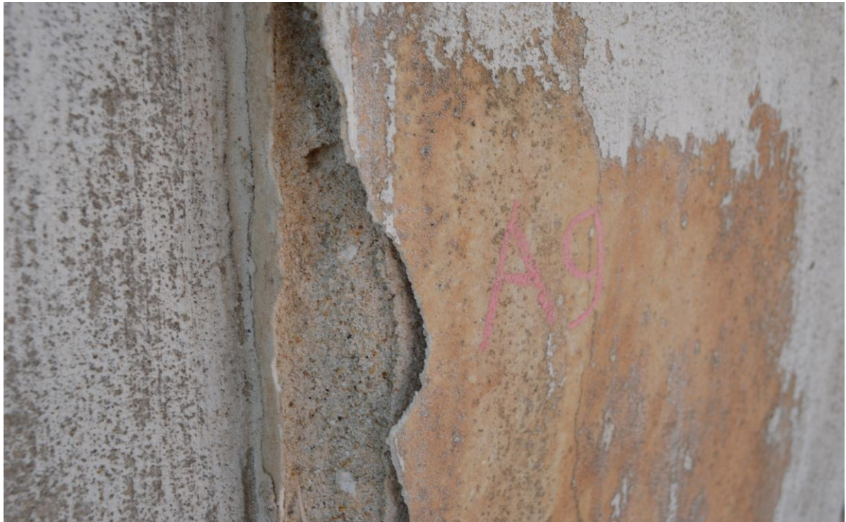
Εικ.48 Αποκόλληση και πτώση τμημάτων των επιχρισμάτων
