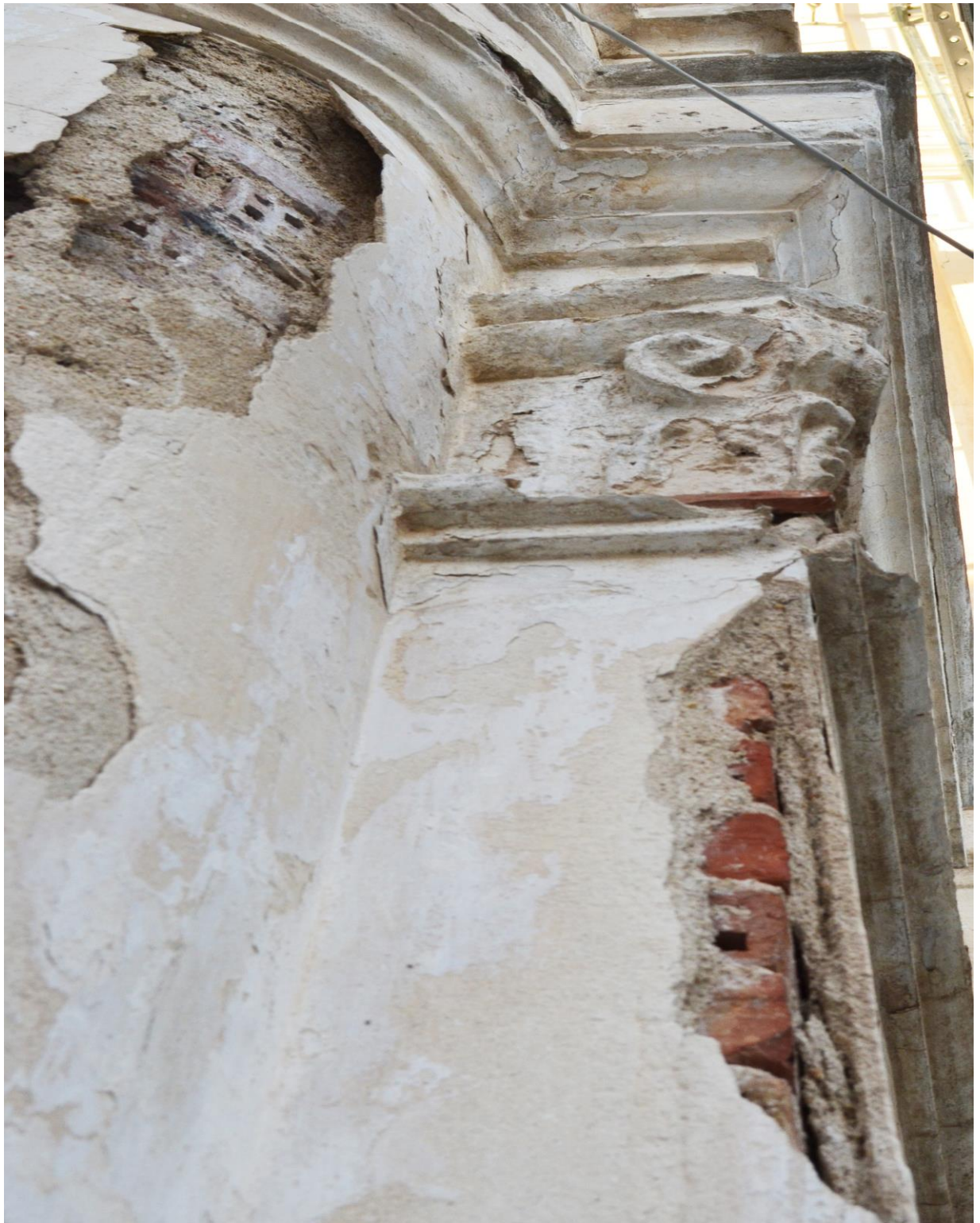
Εικ.47 Αποκόλληση και πτώση τμημάτων των επιχρισμάτων Απολέπιση νεότερου χρωματικού στρώματος
