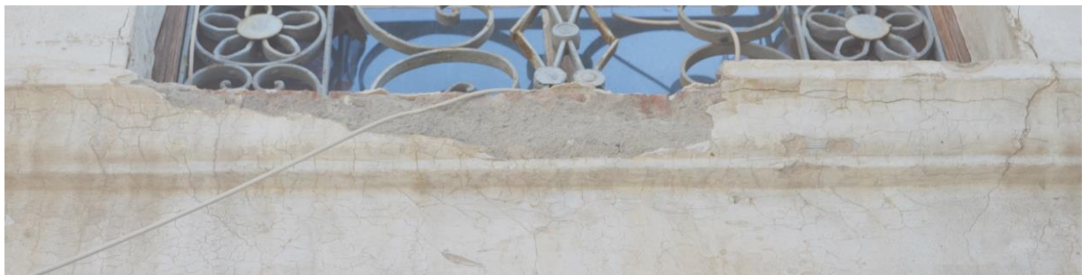
Εικ.57 Απώλεια επιχρίσματος στο τραβηγτό διακοσμητικό στοιχείο
