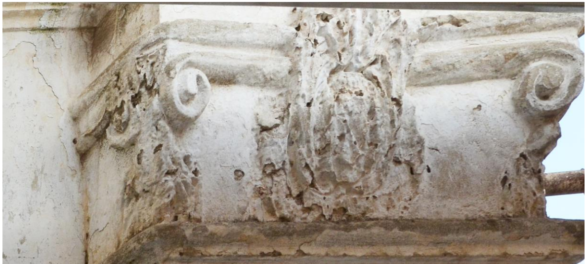
Εικ.60 Σαθροποίηση – Απώλεια τμημάτων γύψινου διακοσμητικού
