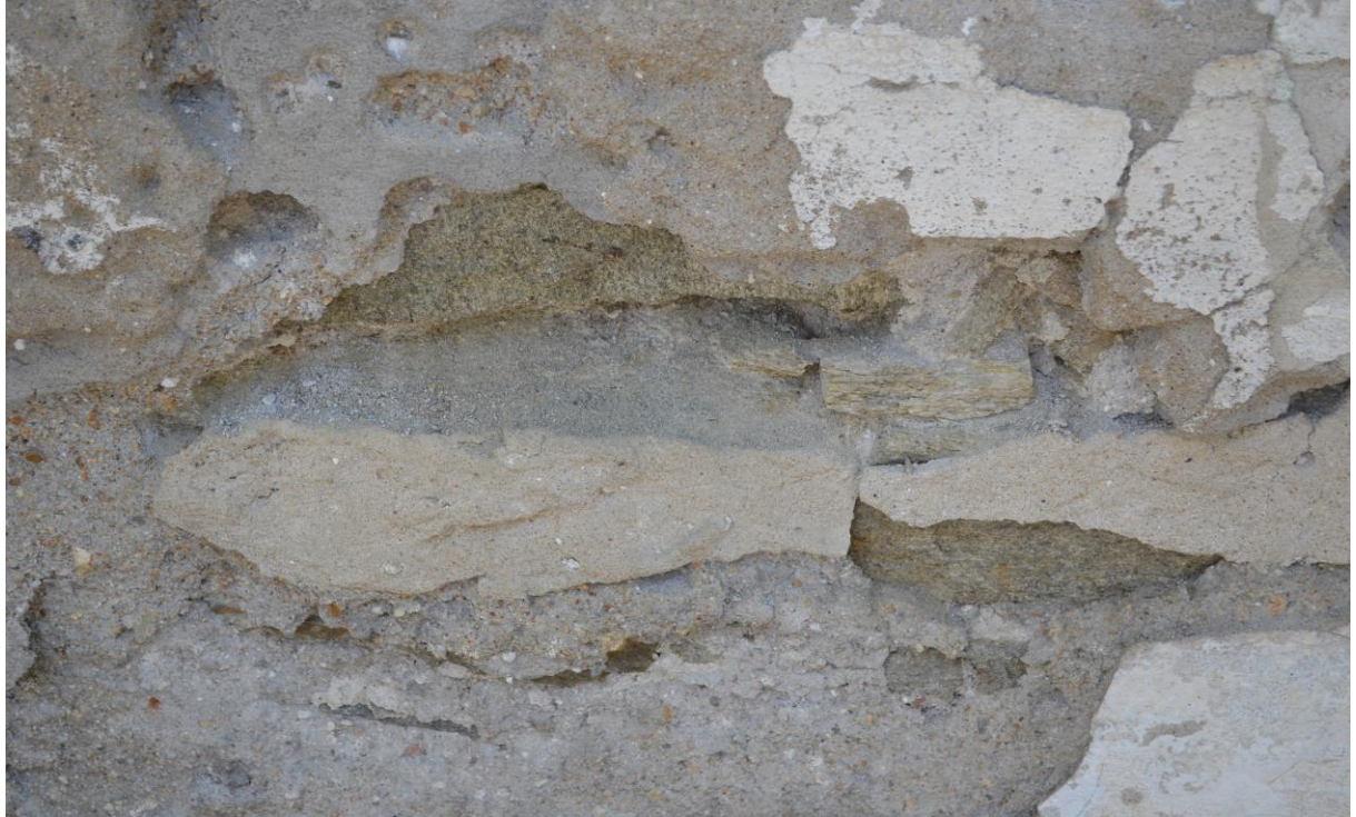
Εικ.50 Αποκόλληση και πτώση τμημάτων των επιχρισμάτων - Προσβολή των κονιαμάτων από ανερχόμενη υγρασία -Κάτω στάθμη
