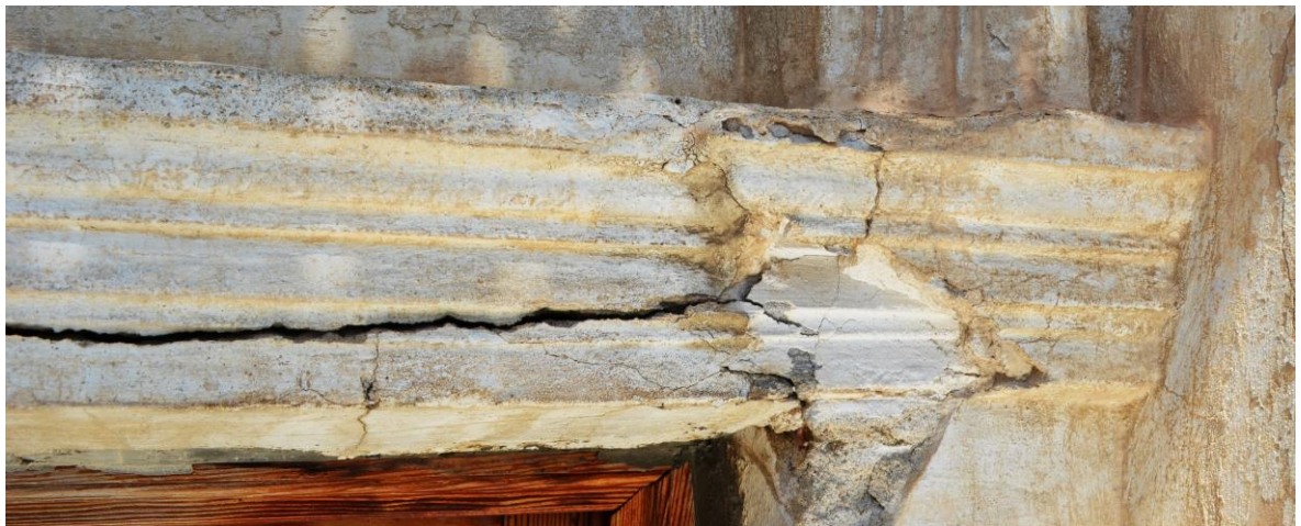
Εικ.42 Ρωγμές-Απώλεια διακοσμητικού στοιχείου
