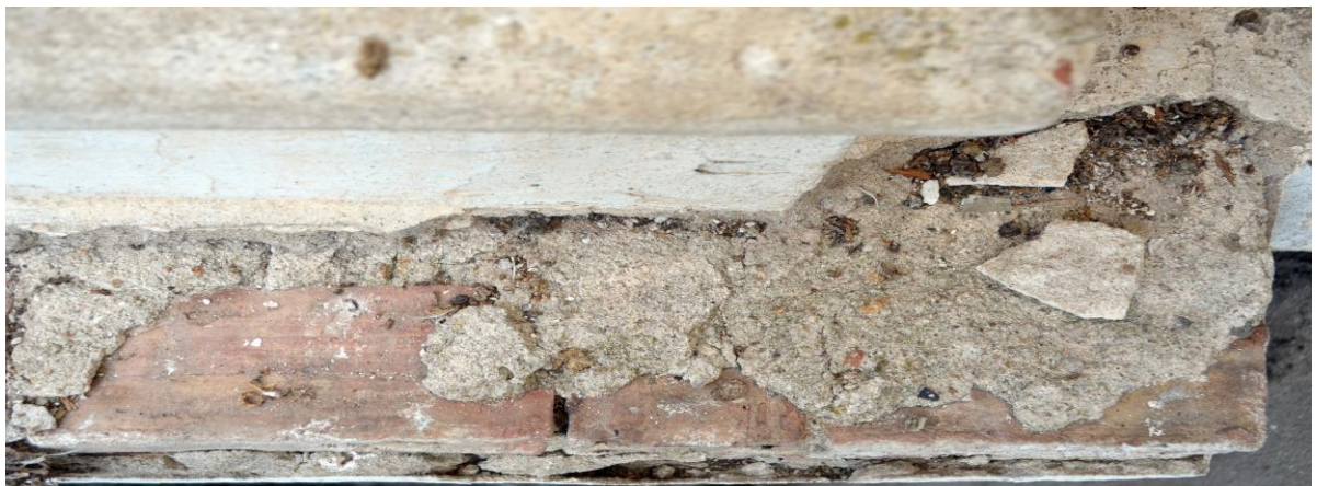
Εικ.58 Μερική και ολική απώλεια κονιάματος στο τραβηγτό διακοσμητικό στοιχείο
